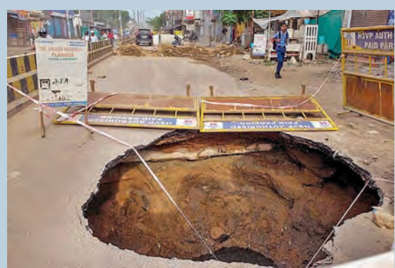
భారీ వర్షానికి సోమవారం గురుగ్రామిలో రహదారిపై ఏర్పడ్డ భారీ గుంత
